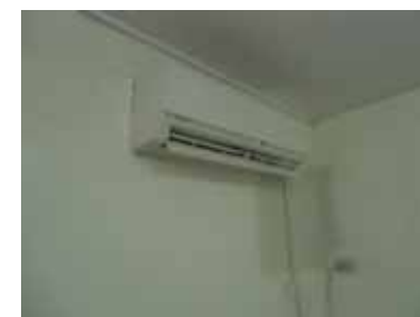
3人部屋限定ですが室外機型のエアコンが！
